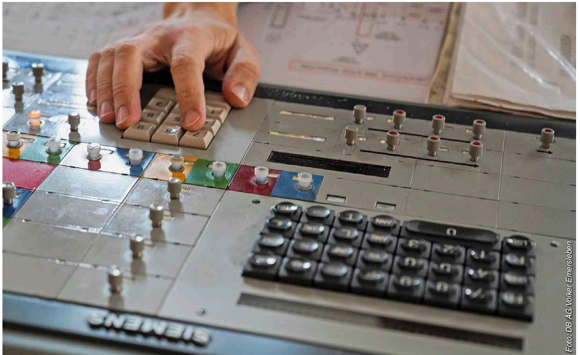
Relaisstellwerk der Bauform Sp Dr S 60 in Mainz-Bischofsheim: Die veraltete Technik erfordert hohen Aufwand für Bedienung und Instandhaltung
