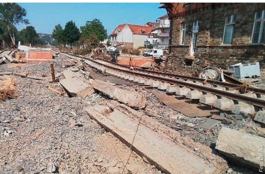
Bahnhof Heimersheim im Ahrtal nach der Flut
